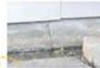
基礎のひび割れ
