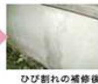
基礎のひび割れ
